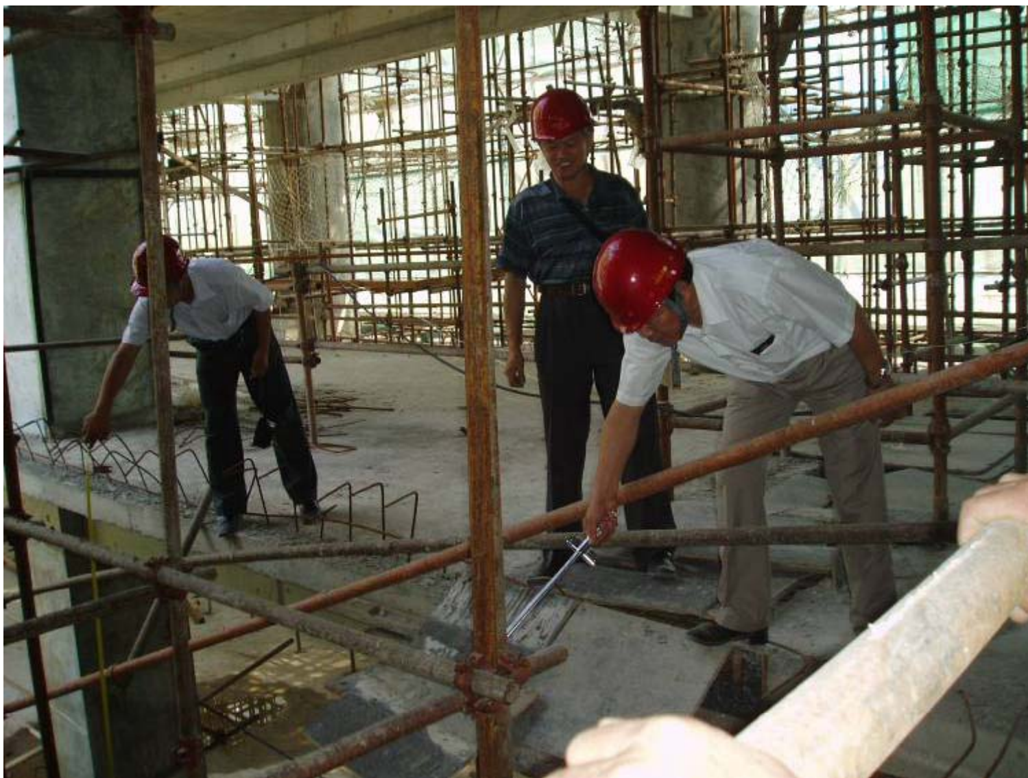
北京“西西工程”事故调查专家用扭力扳手检查扣件拧紧力矩。
