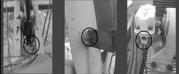
起重重量限制器未接
